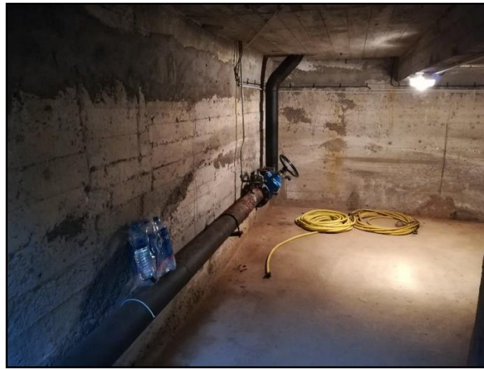
Figure 6 : Photographie de la conduite d'adduction vers le réservoir du Planas
